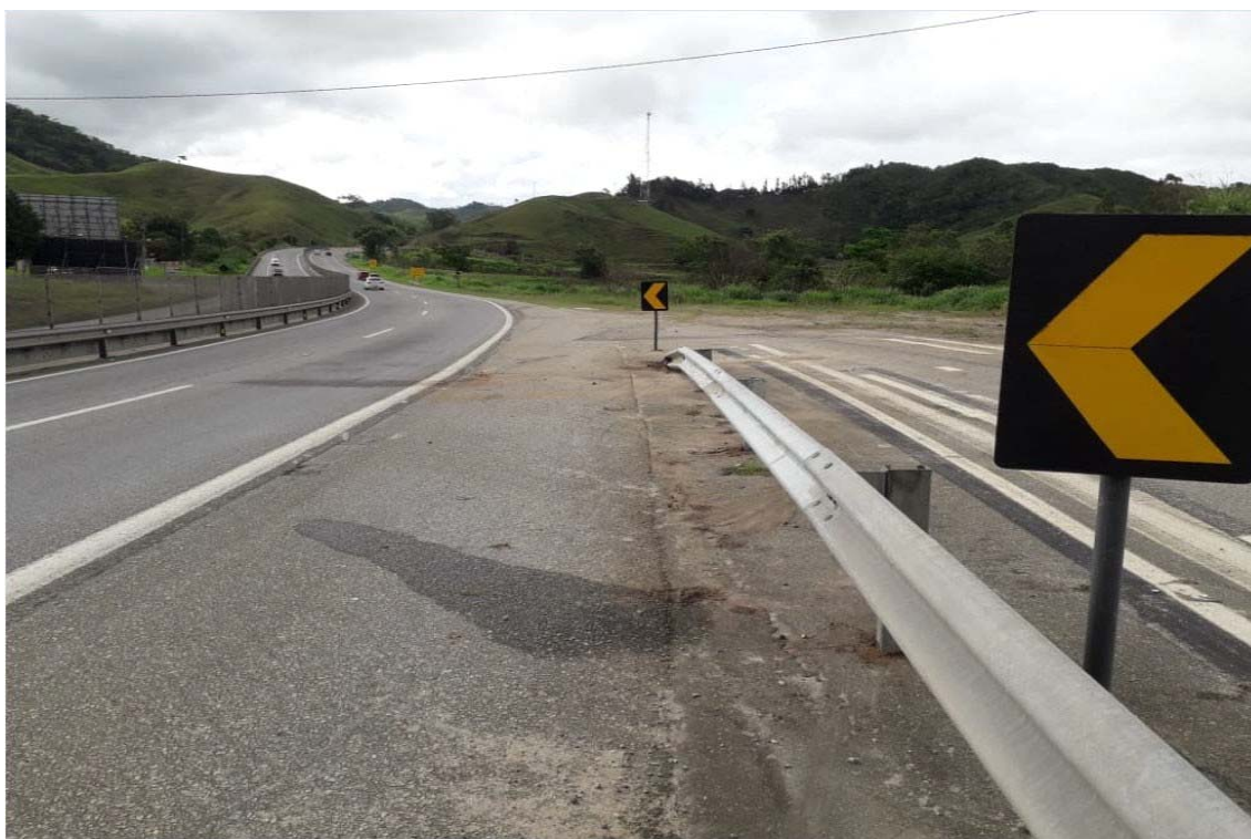
FOTO 10 - Dispositivo de Segurança - Km 8+300 Sul F3
