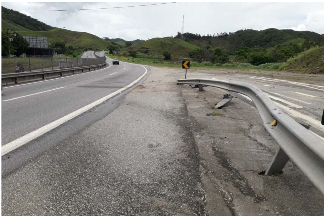
FOTO 08 - Dispositivo de Segurança - Km 8+300 Sul F1
