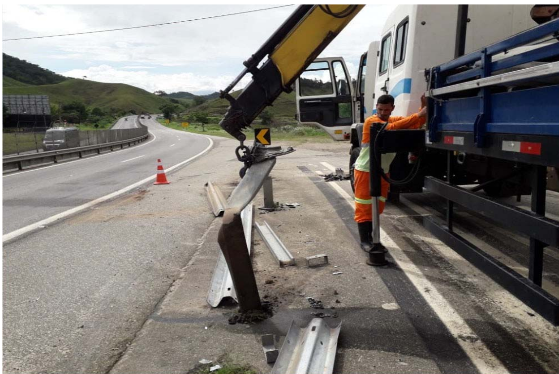
FOTO 09 - Dispositivo de Segurança - Km 8+300 Sul F2
